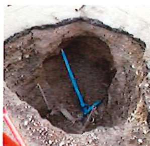
Branchement à l'eau potable
