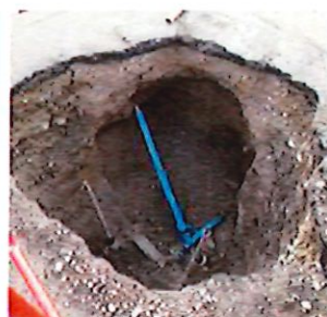
Branchement à l'eau potable
